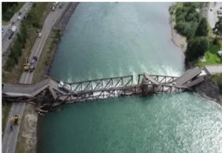
Hình 7: Sự cố sập cầu ở Na Uy, một ví dụ điển hình về hậu quả của sự suy thoái bê tông [1].
